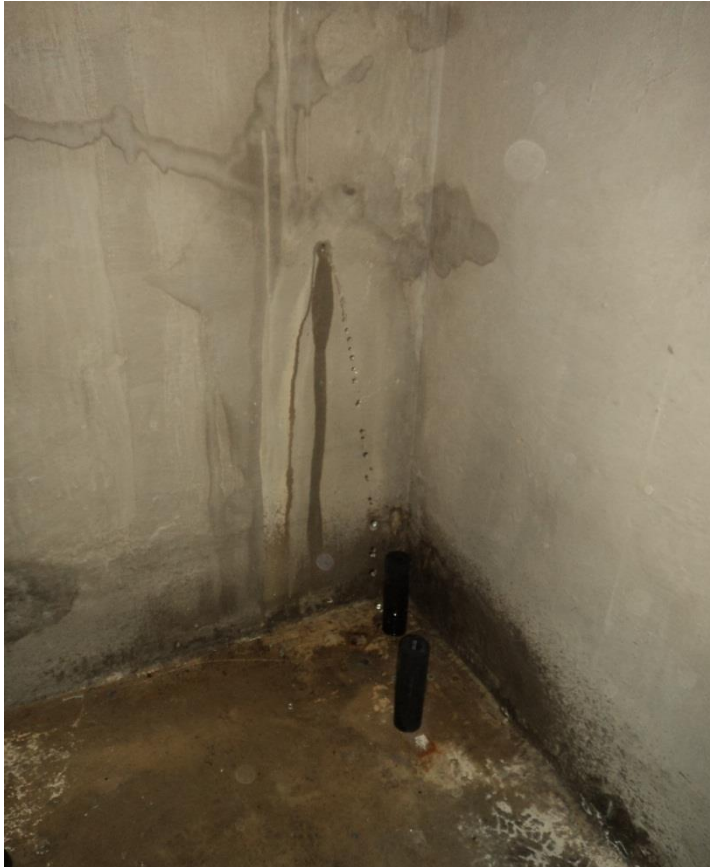
Vazamento interno do Fosso
