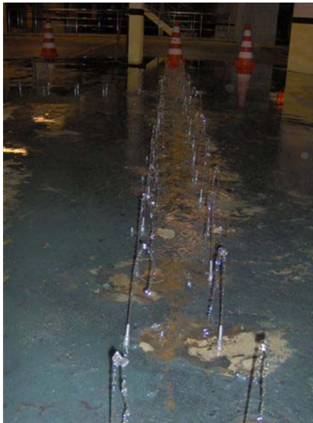
Figura 4 – Bicos de perfuração instalados sem niples
